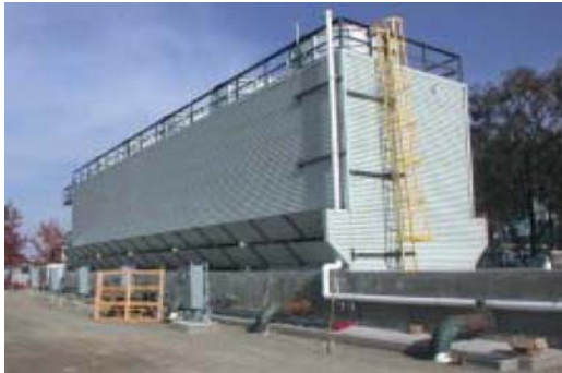
Torre de Refrigeração de 10 MW
