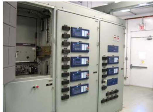
Figura 5—Os relés microprocessados e outros dispositivos elétricos são centralizados. Antigamente, eram usados relés eletromecânicos, necessitando-se de um relé por função. Com relés microprocessados, precisa-se apenas de um relé para múltiplas funções.
