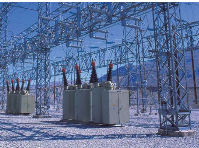
Fig. 1. As concessionárias necessitam mão-de-obra especializada para suportar o sistema de potência.
