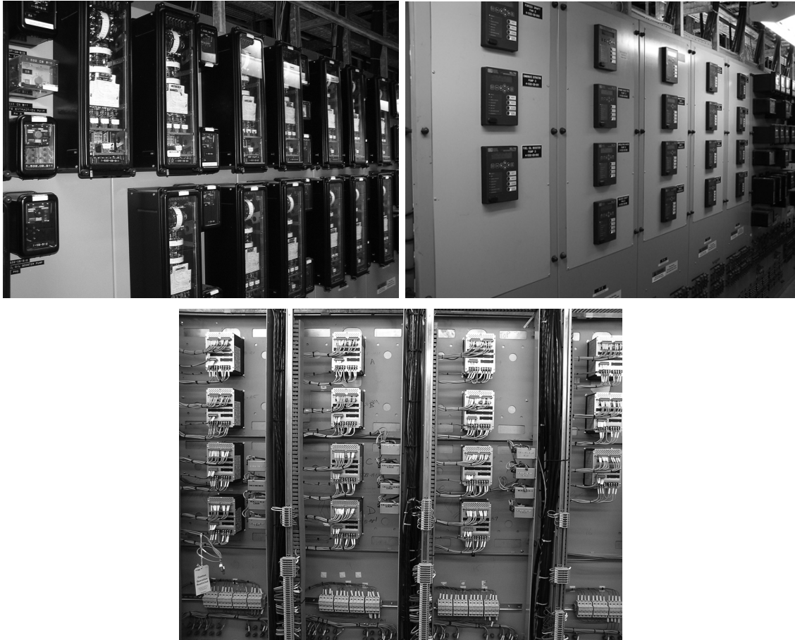
Fig. 3. Retrofit da Proteção de Motores
