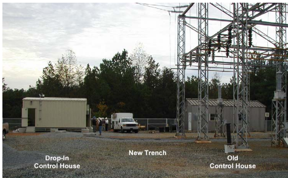
Figura 2 Casas de Controle Antiga e Nova na Subestação Belmont Tie
